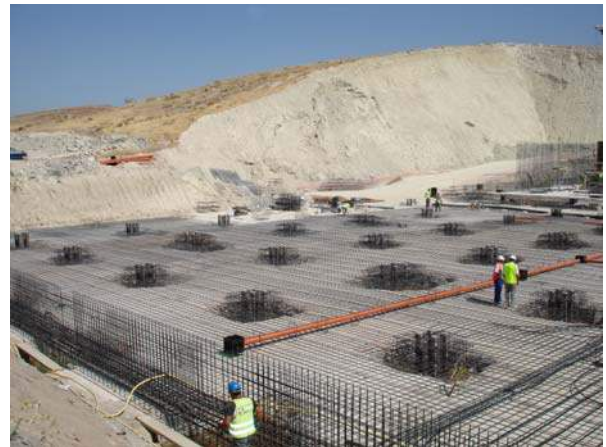
Proceso de armado de losa de cimentación y elementos de conexión pilotes, losa y pilares
